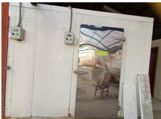
Figura 23. Cámara de refrigeración
